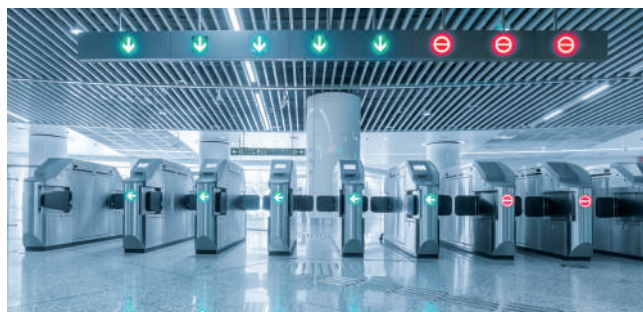
Система контроля и управления доступом
